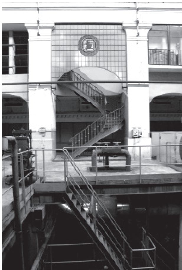
Fot. D. Walerjański Wnętrze elektrowni Zaborze na Zaborzu
